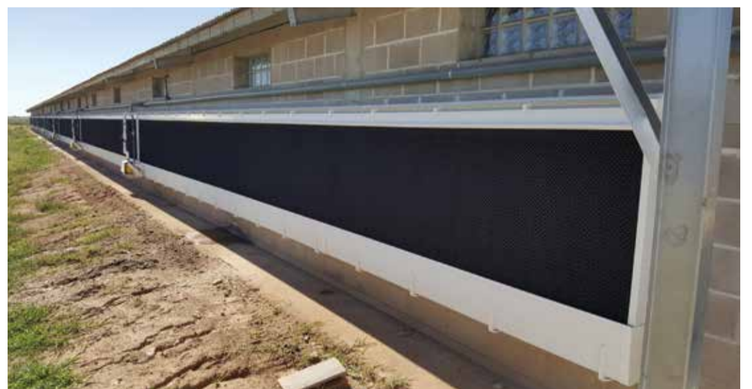
El sistema de refrigeración con pads ofrece temperaturas agradables en los galpones.
