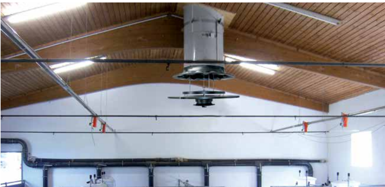
Ventilation assurée par distributeur d'air
