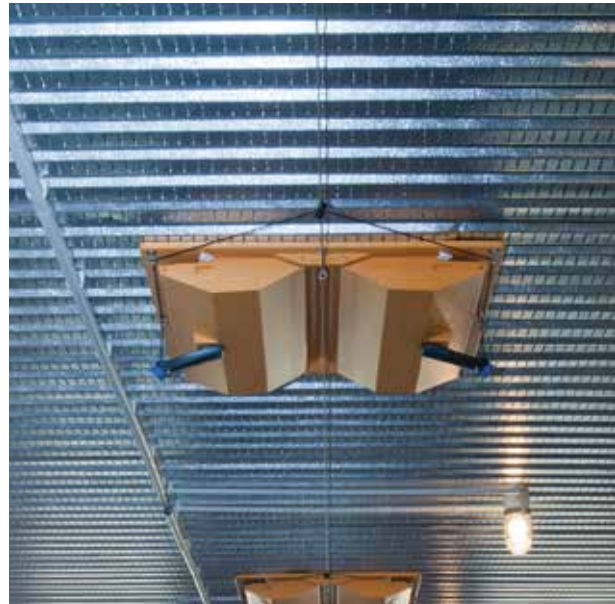
Plafond en aluminium
