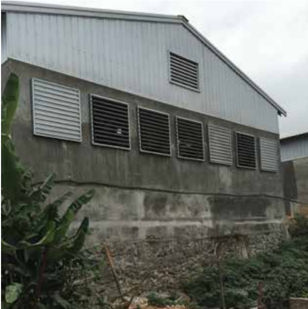
Ventilation combinée tunnel
