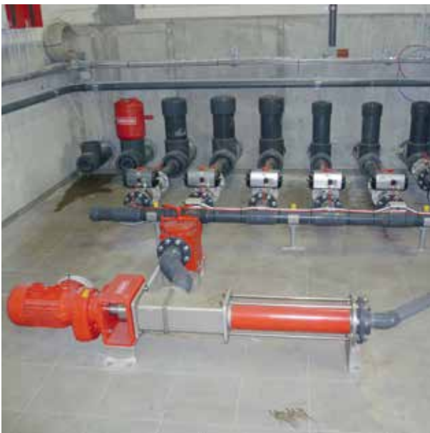
Unité de pompage pour les coproduits
