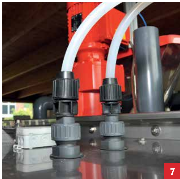
Raccord de nettoyage à l'acide/alcalin au niveau de la cuve de mélange
