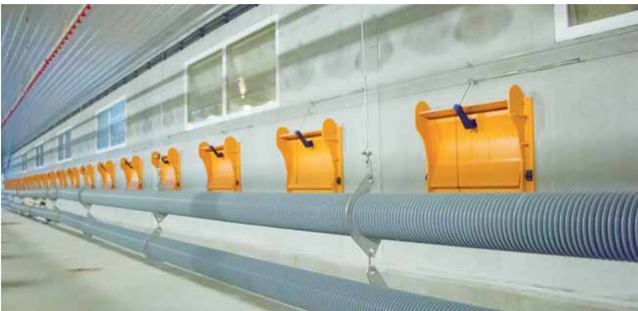
Ventilation à rayonnement
