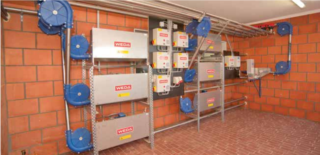
Système d'alimentation sèche avec 6 lignes d'alimentation
