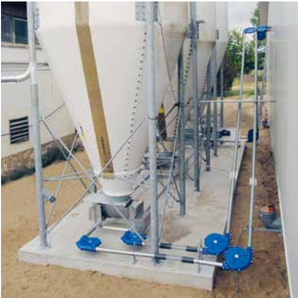
Silos extérieurs pour l'alimentation sèche
