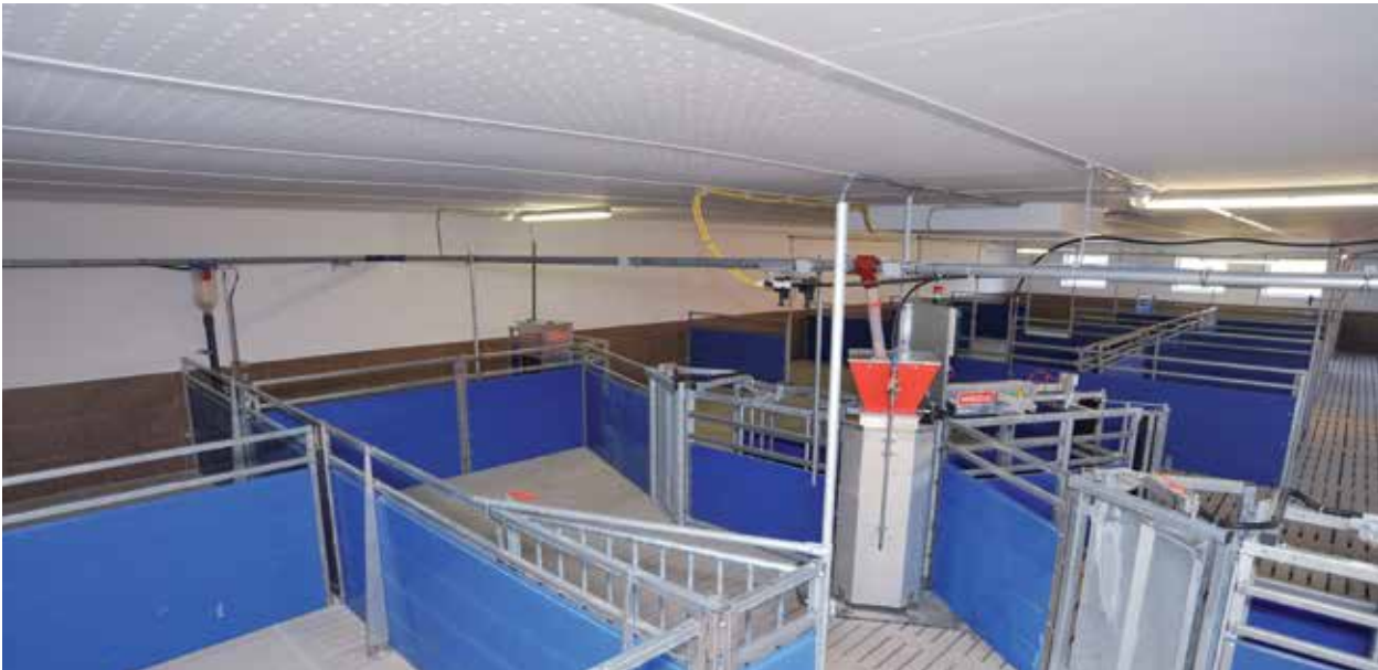
Ventilation à plafond diffuseur
