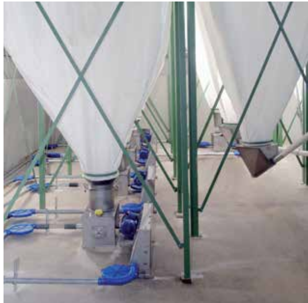
Silos intérieurs pour l'alimentation sèche
