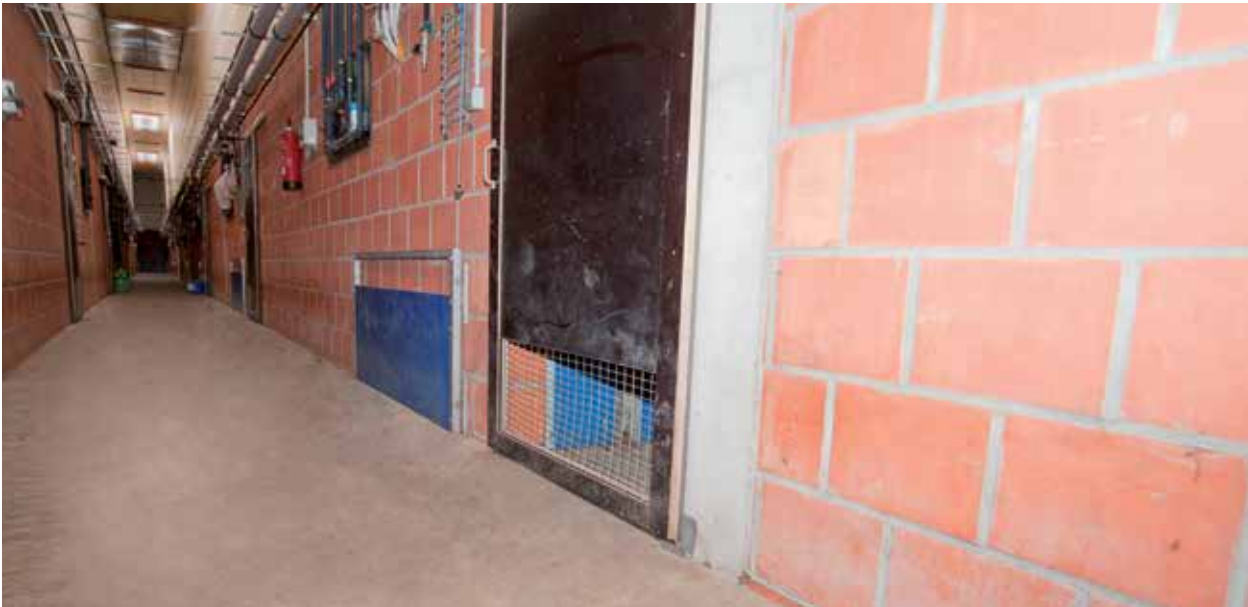
Ventilation Couloir par passage de porte
