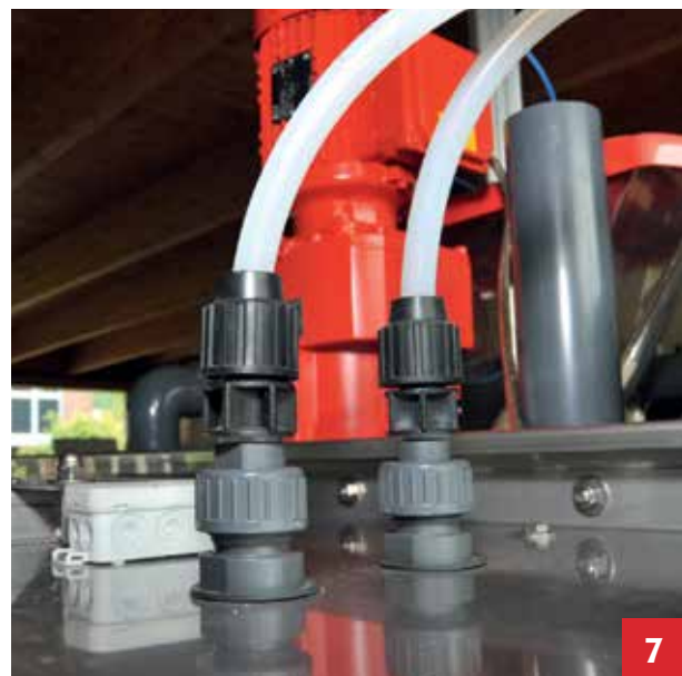
Savas és lúgos mosás csatlakozása a keverőtartályra
