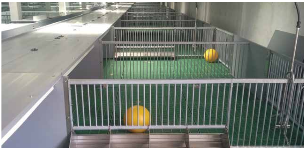
Станок опороса для туннельной вентиляции
