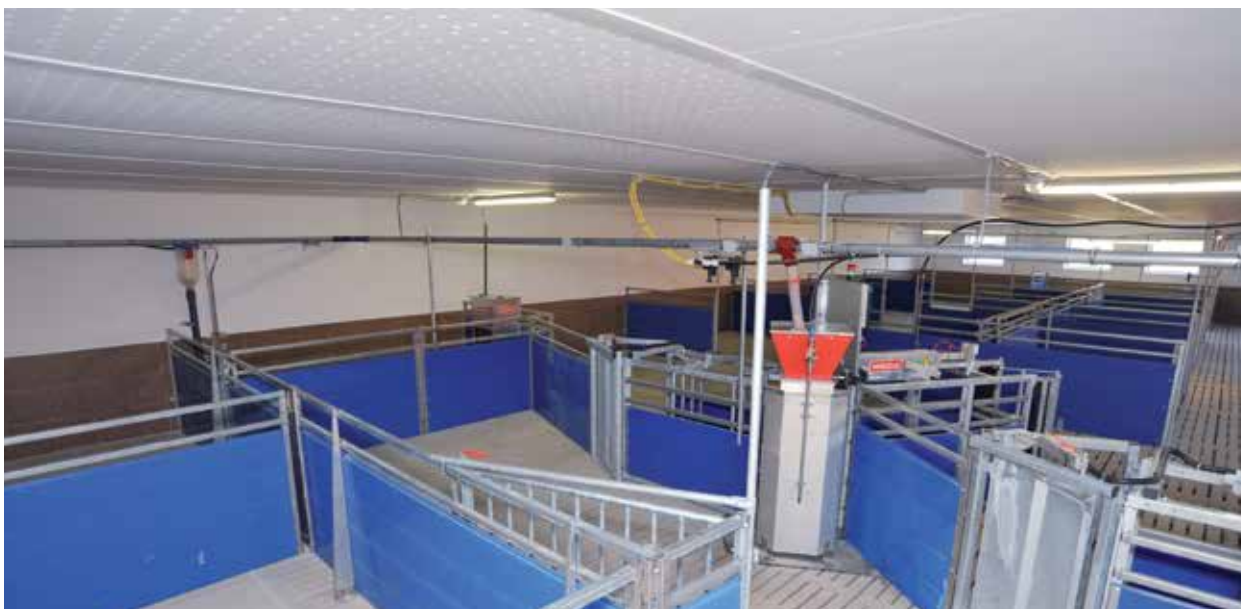
Приточная вентиляция через перфорированный потолок
