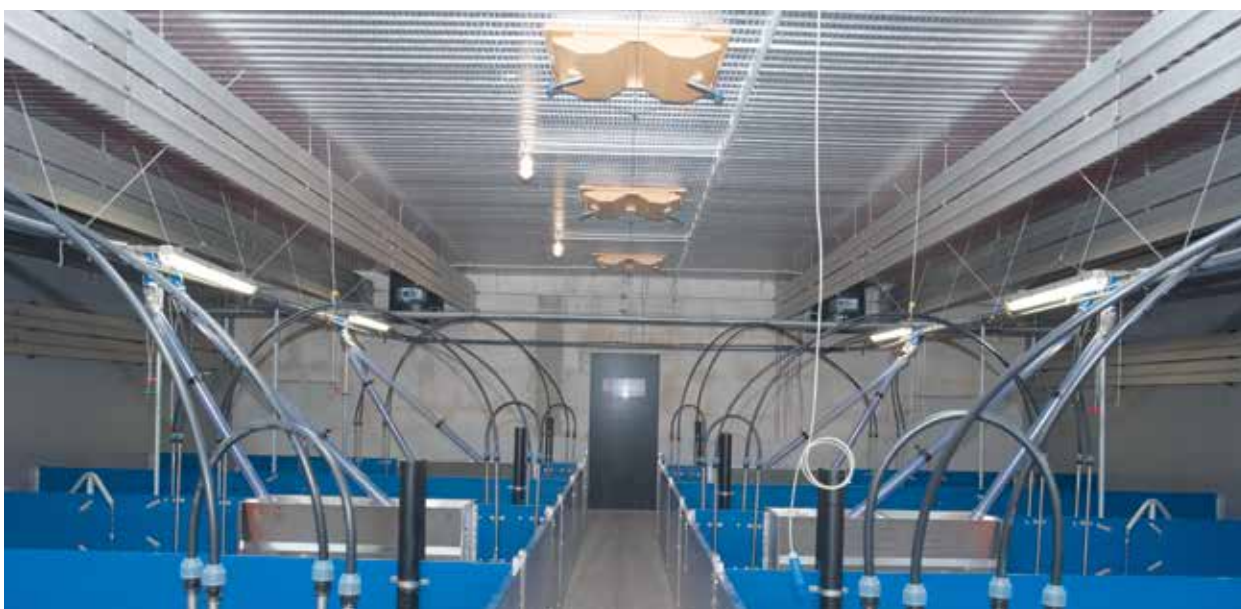
Комбинированная приточная вентиляция
