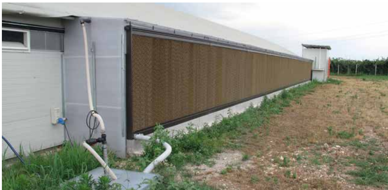
Система блок-камер охлаждения увлажнением
