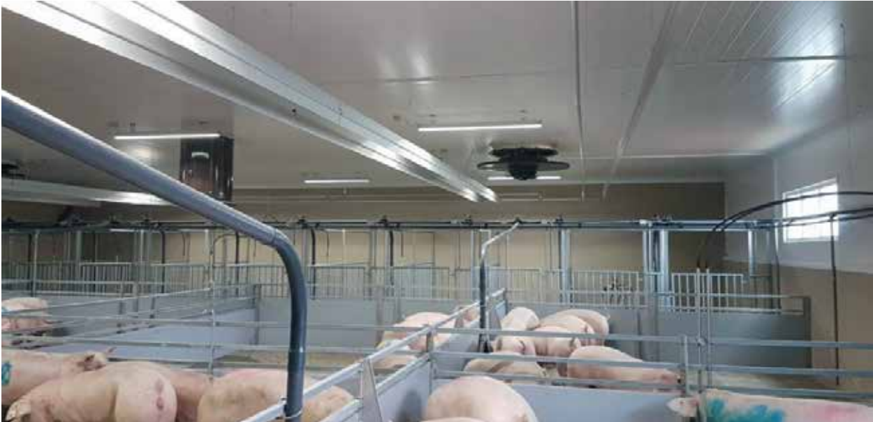
공급 공기 분배기를 이용한 환기
