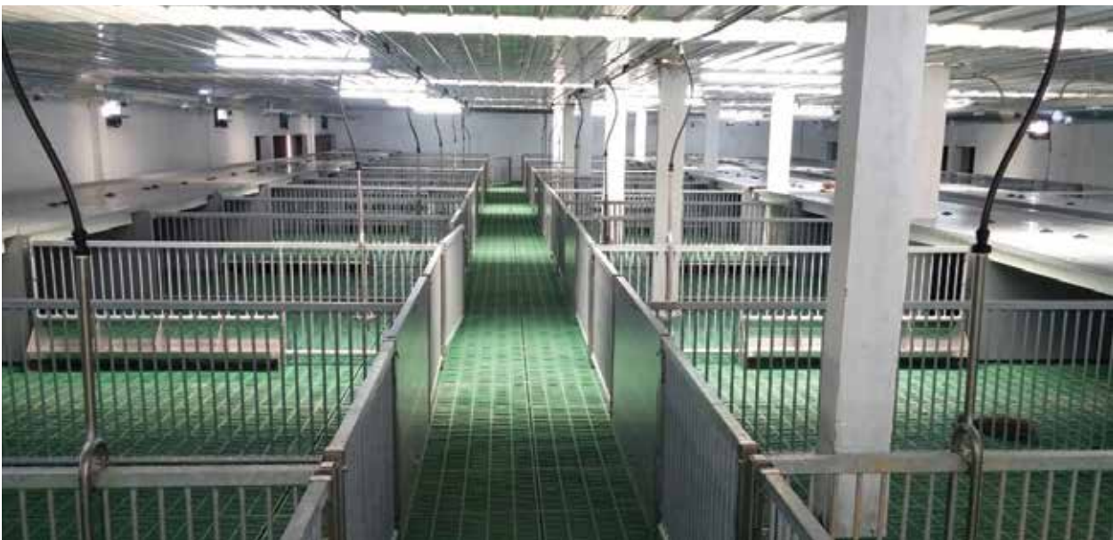
혼합 터널 환기
