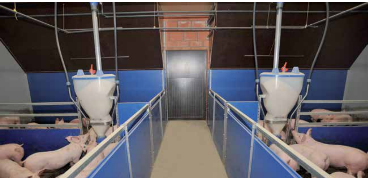
출입문 통로 환기
