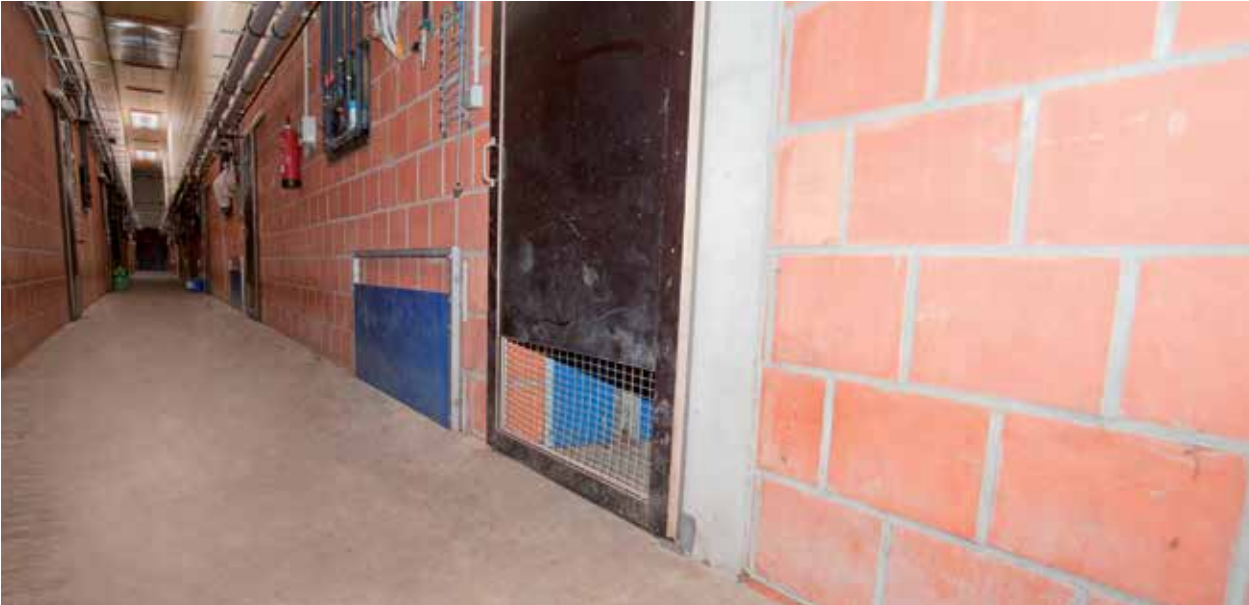
출입문 통로 환기
