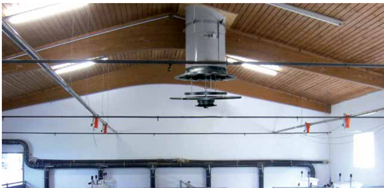
Wentylacja z dystrybutorem powietrza nawiewanego
