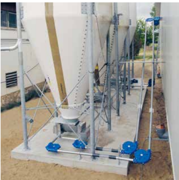
Silosy zewnętrzne do karmienia na sucho
