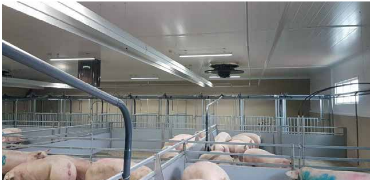
Wentylacja z dystrybutorem powietrza nawiewanego
