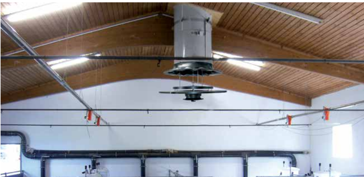
Ventilação com distribuidor de ar
