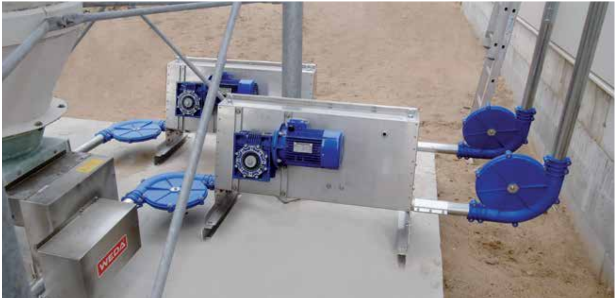
Estação de acionamento K1
