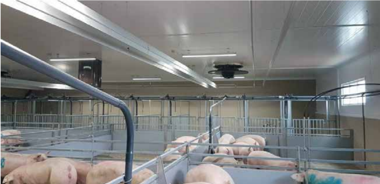
Ventilação com distribuidor de ar
