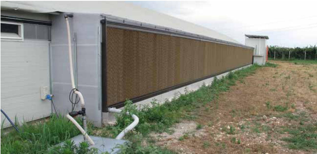
Sistema climatizador PAD
