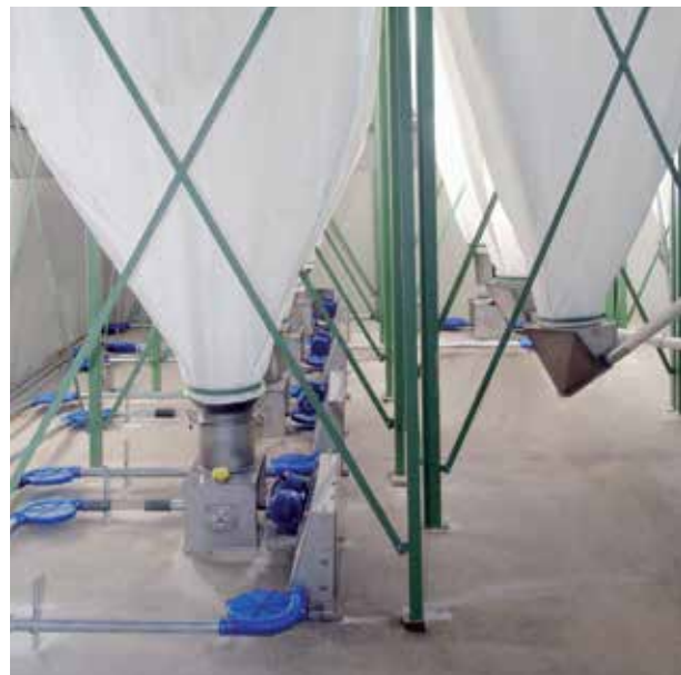
Silos internos para alimentação seca
