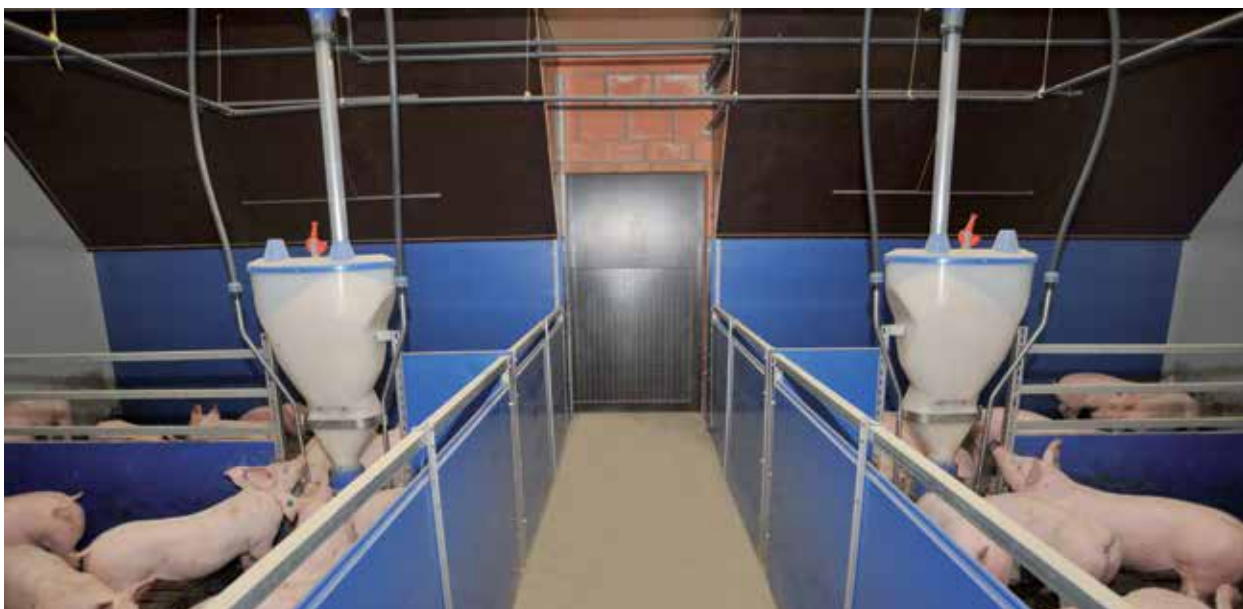
Ventilação pela porta do corredor
