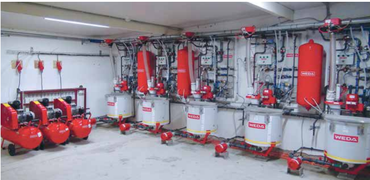
Sistema para 2500 matrizes com trato paralelo (esta instalação é para até 4000 matrizes)
