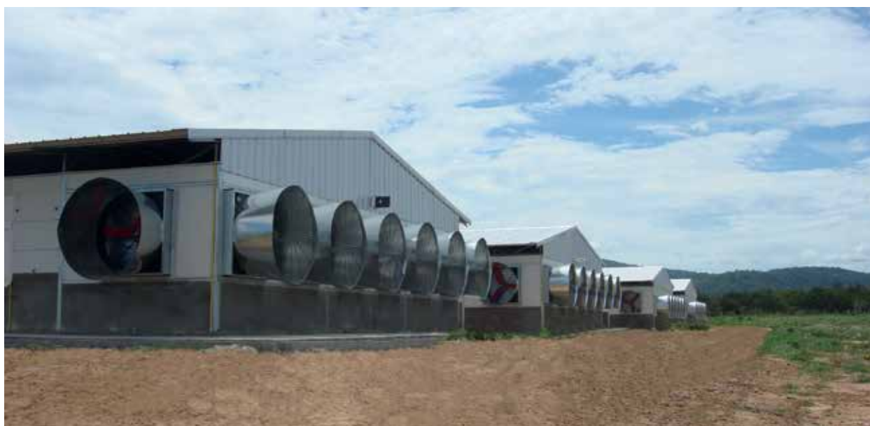
Ventilație de tip tunel cu ventilatoare conice
