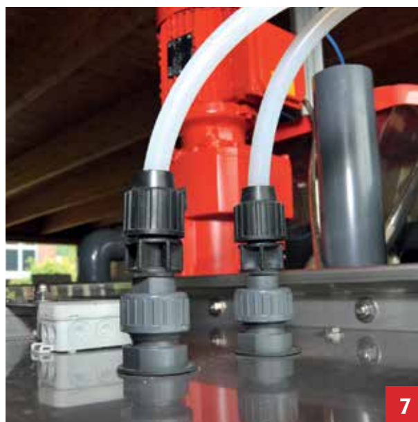
Conexiunea de curățare acid/leșie la rezervorul de mixare
