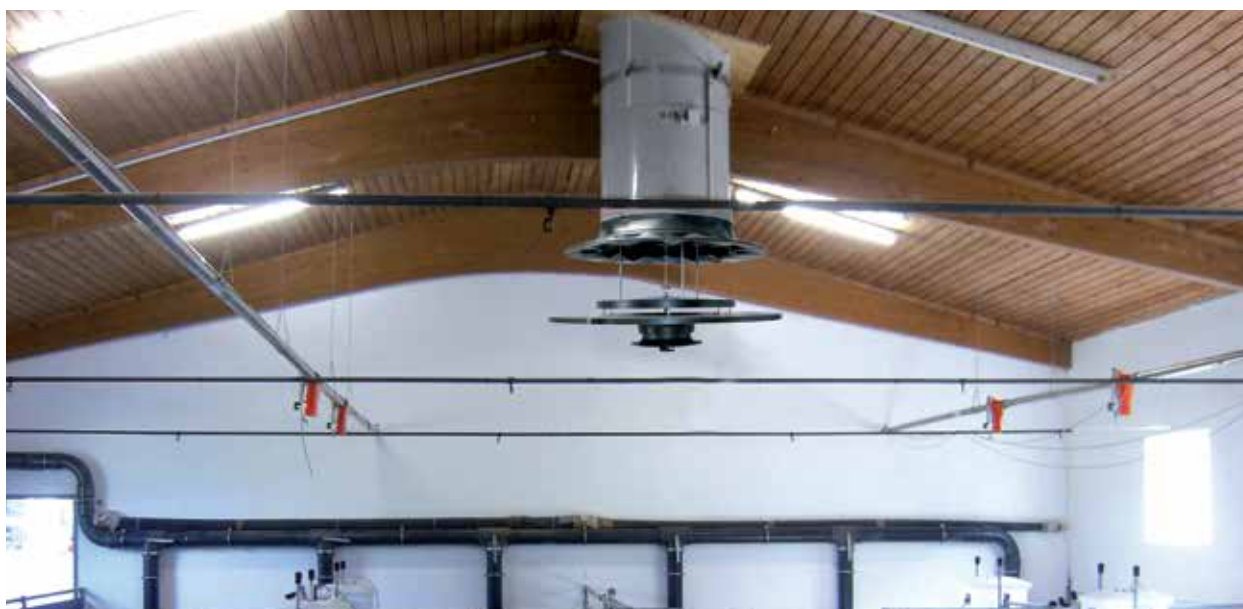
Ventilație cu distribuitor alimentare aer
