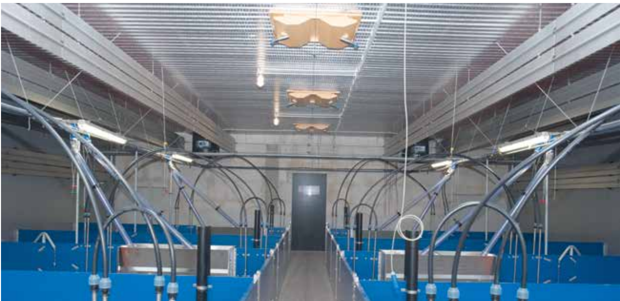
Ventilație difuză combinată
