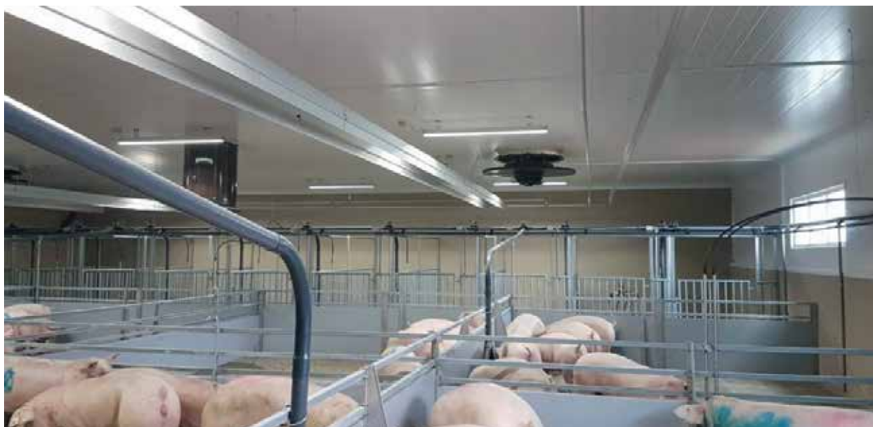
Ventilație cu distribuitor alimentare aer
