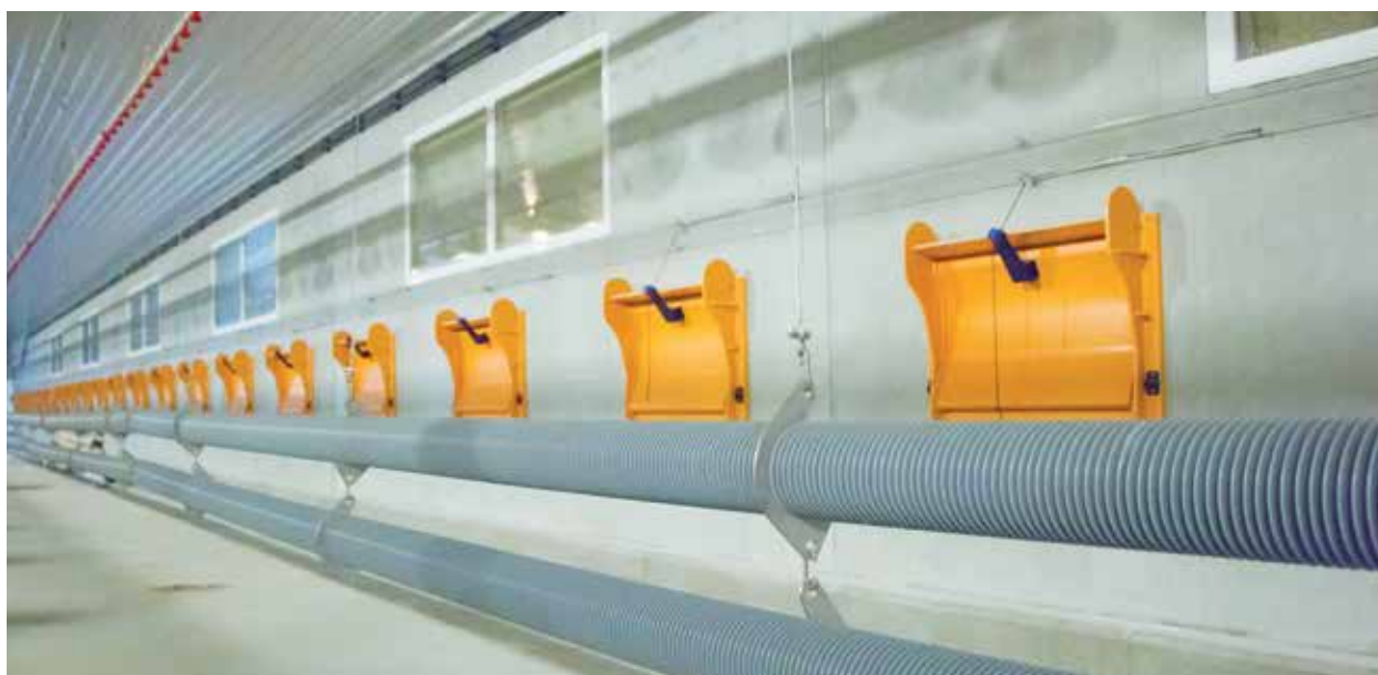
Ventilație cu jet
