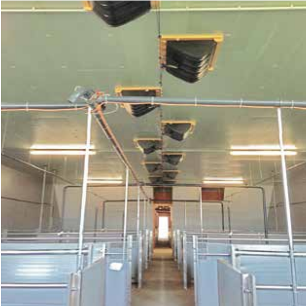
วาล์วจ่ายอากาศที่เพดาน
