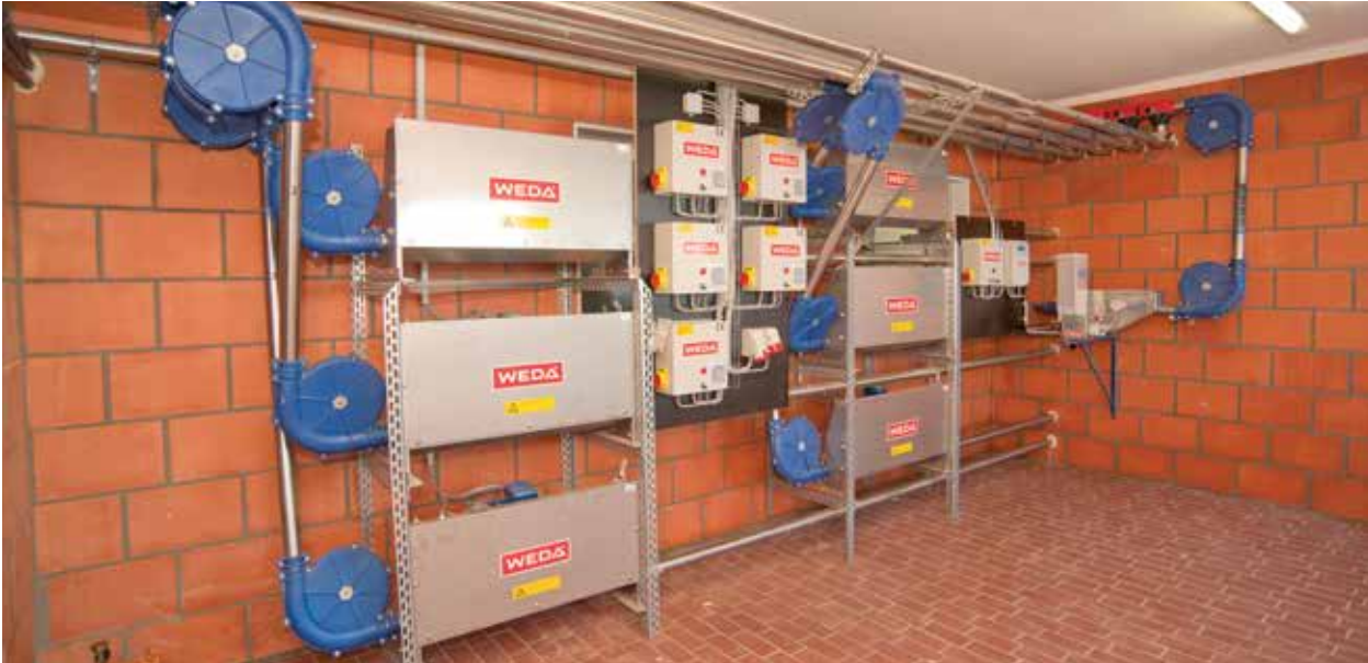
ระบบการให้อาหารแห้งที่ควบคุมจากระบบศูนย์กลาง พร้อมด้วยสายส่งอาหาร 6 สาย
