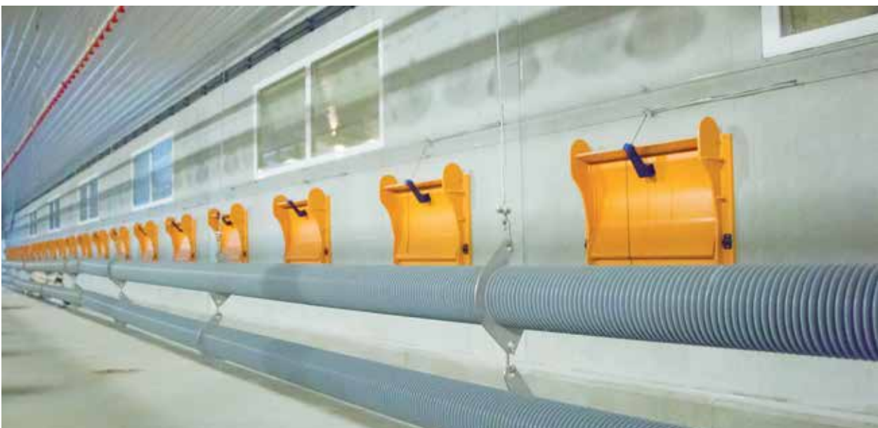
ระบบระบายอากาศแบบเจ็ต
