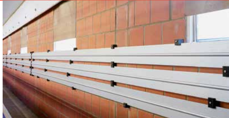
...und die Heizung (hier Twinrohrheizung)
